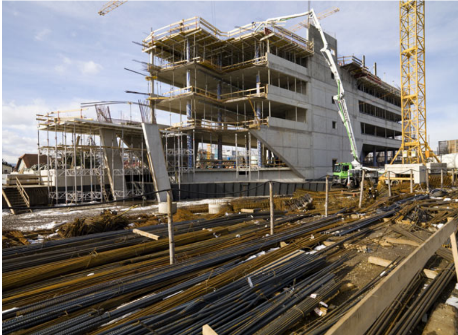
Abb. 11: Mobile Autobetonpumpe und Ausschnitt der Lagerflächen für die Bewehrung vom Projekt Headquarter der UNIOPT Pachleitner Gruppe 92
