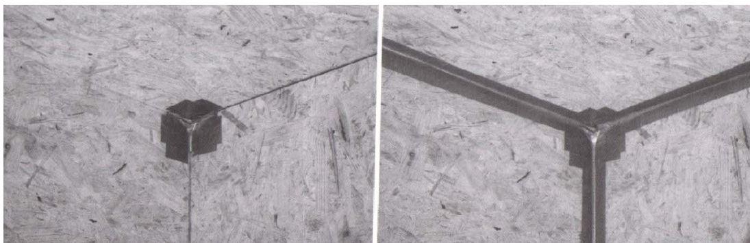
Abb. 3-38: Fachgerechtes luftdichtes Abkleben eines 3D-Werkstoffplattenanschlusses (Bild OSB-Platten). Vorerst wird die Ecke dreifach zwischen zwei Platten abgeklebt (linkes Bild) und erst danach werden die daran anschließenden linienförmigen Plattenverbindungen verklebt (Bild rechts). [24], S.28
