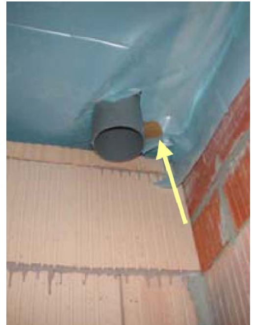
Abb. 3-51: konvektive Wärmebrücke bei einer unsachgemäßen Entlüftungsrohrdurchführung durch die Dichtebene des Daches, [84]
