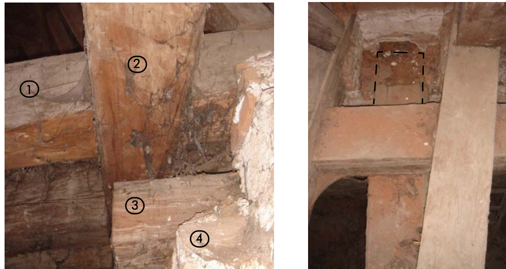
Abb. 9.8: BT (1), MB (2), Kragträger (3), gemauerte Konsole (4) (links, Ansicht von unten); morscher Träger (rechts, Draufsicht)
