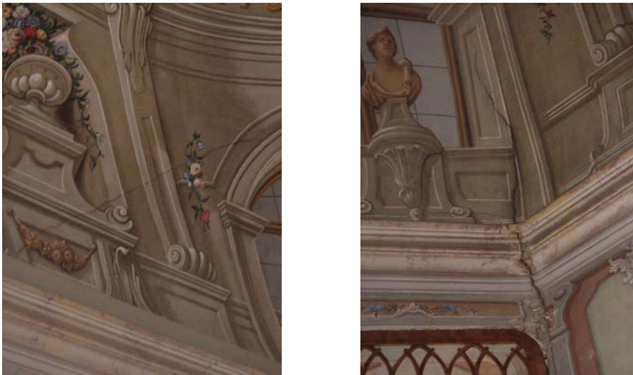
Abb. 4.1: Rissbildung im Gewölbe des Festsaals
