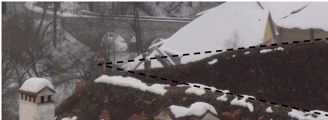
Abb. 5.7: Absenkung des Firstes
