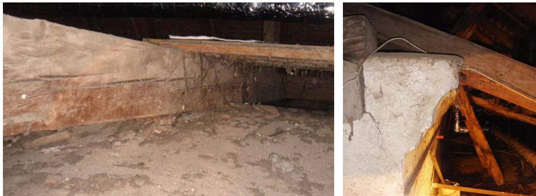
Abb. 5.24: BT liegt auf dem Gewölbe mittig auf (links), Gesimse (rechts)
