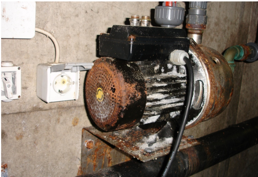
Abbildung 6-18 Pumpe mit korrosiven Schäden
