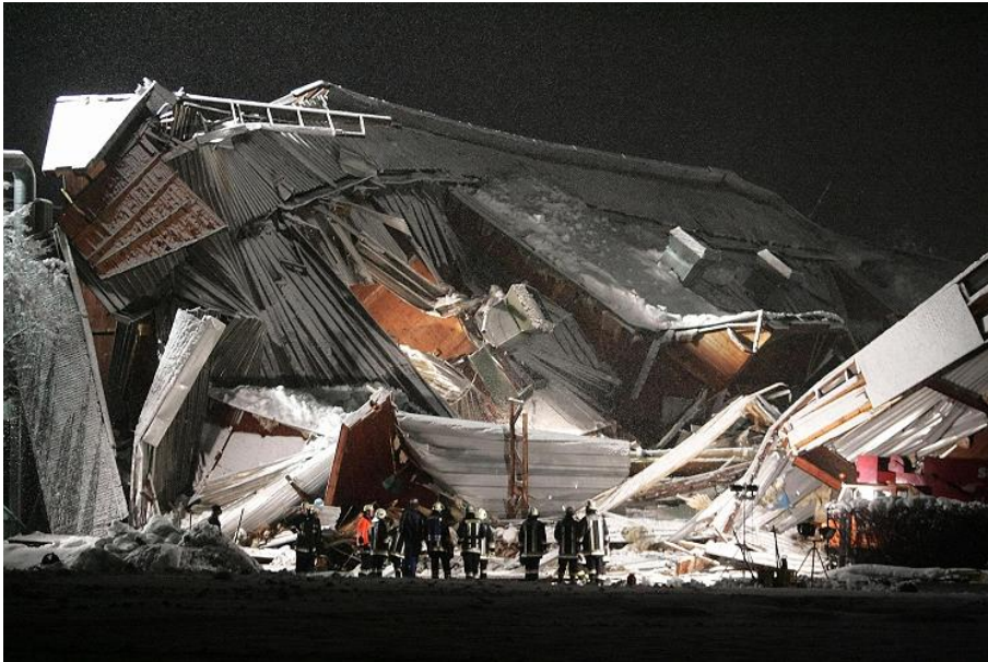
Abbildung 3-7 Einsturz Eissporthalle Bad Reichenhall 54
