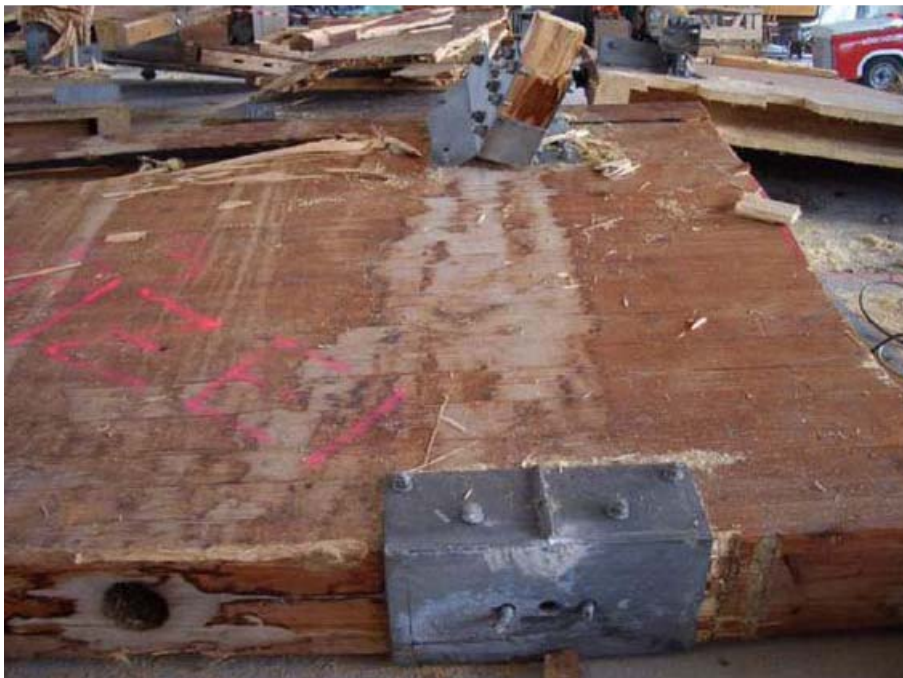
Abbildung 3-5 Durchfeuchtungen an den Dachträgern 51
