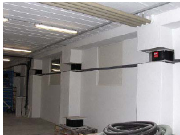
Abbildung 2.11: Erdbebenlager im Kellergeschoss mit horizontal durchgeschnittenen Außenwänden [11]
