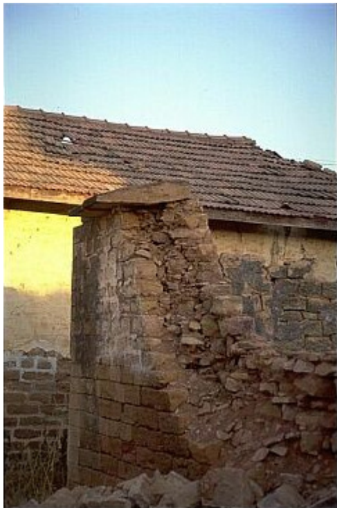
Abbildung 4.9: Schwacher Verbund der Mauerwerkswände durch schlechten oder fehlenden Mörtel [23]
