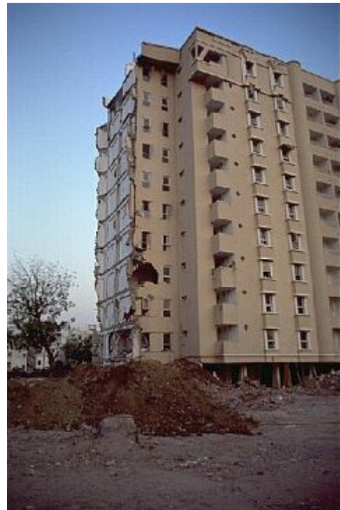
Abbildung 4.10: Hausteil links völlig eingestürzt, Erdgeschoss des rechten Hausteil stark beschädigt [23]
