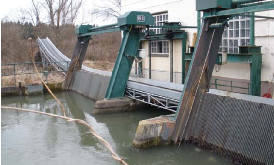
Abbildung 4.32: Zulauf zu den Turbinen
