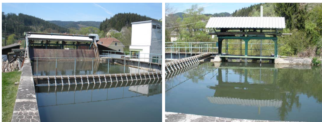
Abbildung 4.37: Zulauf Turbine mit seitlicher Entlastung
