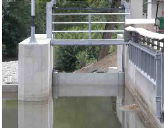
Abbildung 4.13: Schütz mit Klappe und rechts der Einlauf zu den Turbinen
