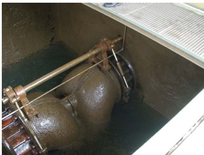
Abbildung 4.45: Einlauf zu den Turbinen
