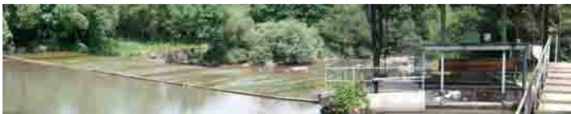
Abbildung 4.44: Wehranlage mit Schütz
