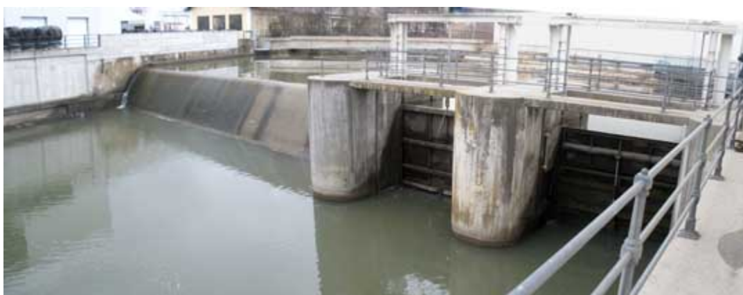
Abbildung 4.26: Wehranlage: festes Wehr, Tafelschütz III, Tafelschütz II mit Klappe
