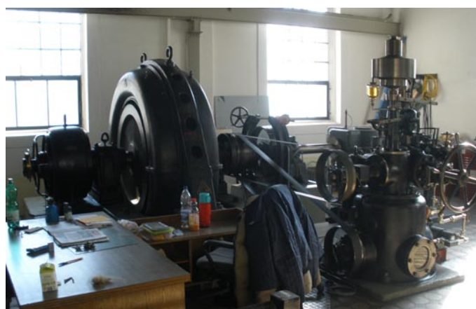
Abbildung 4.23: Maschinenraum, im Bild der ältere Maschinensatz
