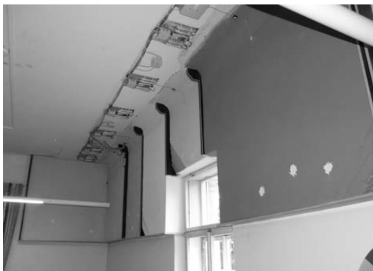
Abb. 6. Versuchsanordnung mit unterschiedlichen Dämmsystemen und Messgeräten im Aufenthaltsraum im 1.OG
