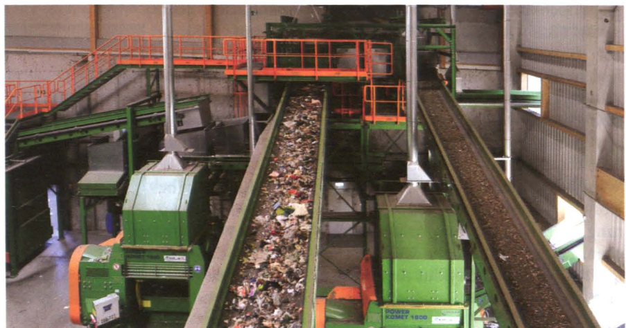
ABBILDUNG 3: ANLAGENTECHNIK IN DER ERSATZBRENNSTOFFAUFBEREITUNG
