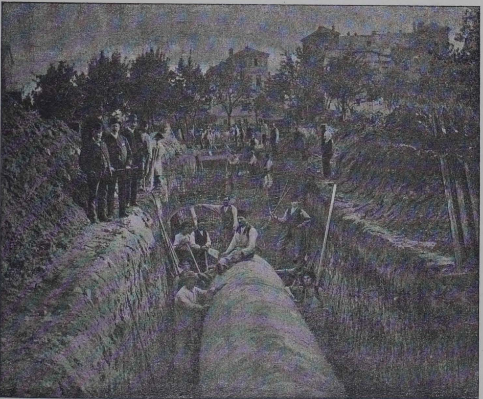
Kanalanlage in Offenbach a/Main. Rohrweite 1,50 m.
