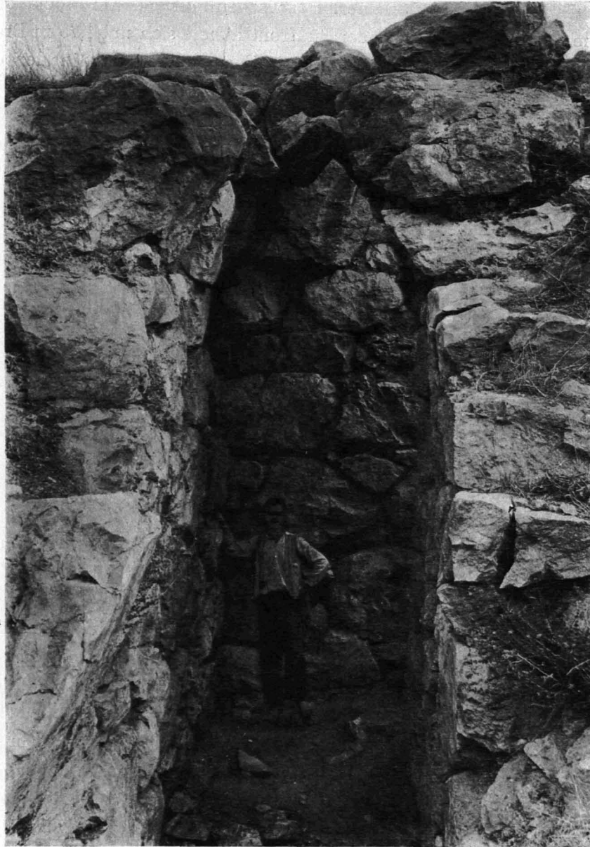
Abb. 39. Treppe zur Südgalerie. Unterer Arm von Süden. a: Schräger Stein der Türwölbung.
