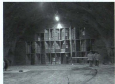
Elektrofilter für Tunnelabluftreinigung
