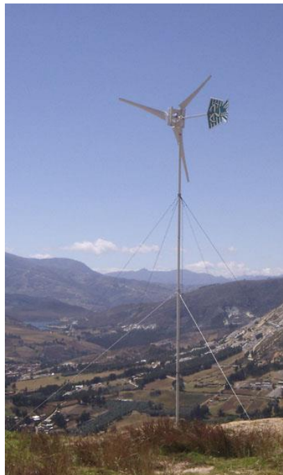
Abbildung 2-15: Windkraftanlage mit abgespannten Turm [28]
