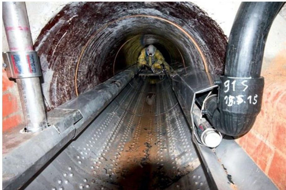
Abbildung 45: Abwasser-Wärmepumpe in der deutschen Stadt Lübeck [WP AbWL 2017]
