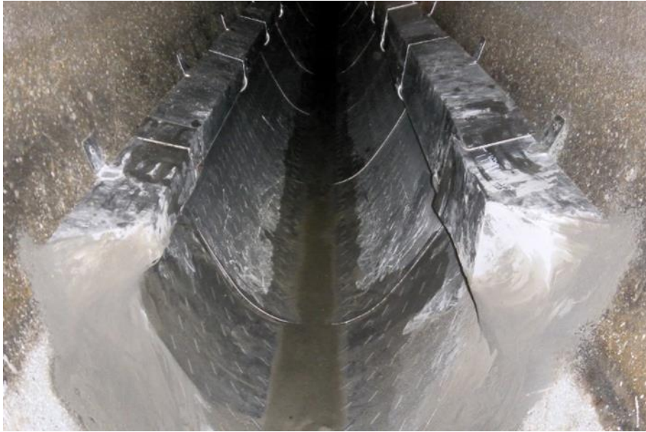
Abbildung 43: Wärmetauscherflächen im Abwasserkanal in Amstetten [WP AbWAm 2017]
