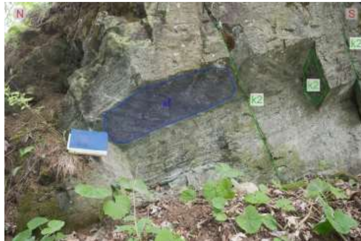
Abb. 4-8: steil nach Süden einfallende Kluftscharen bei WP5
