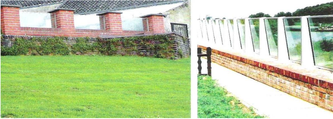
Abbildung 86: In die vorhandene Bausubstanz integrierte Glaswände (links), auf eine Brüstungsmauer montierte Glaswand mit Stützen (rechts) (BWK, 2005)
