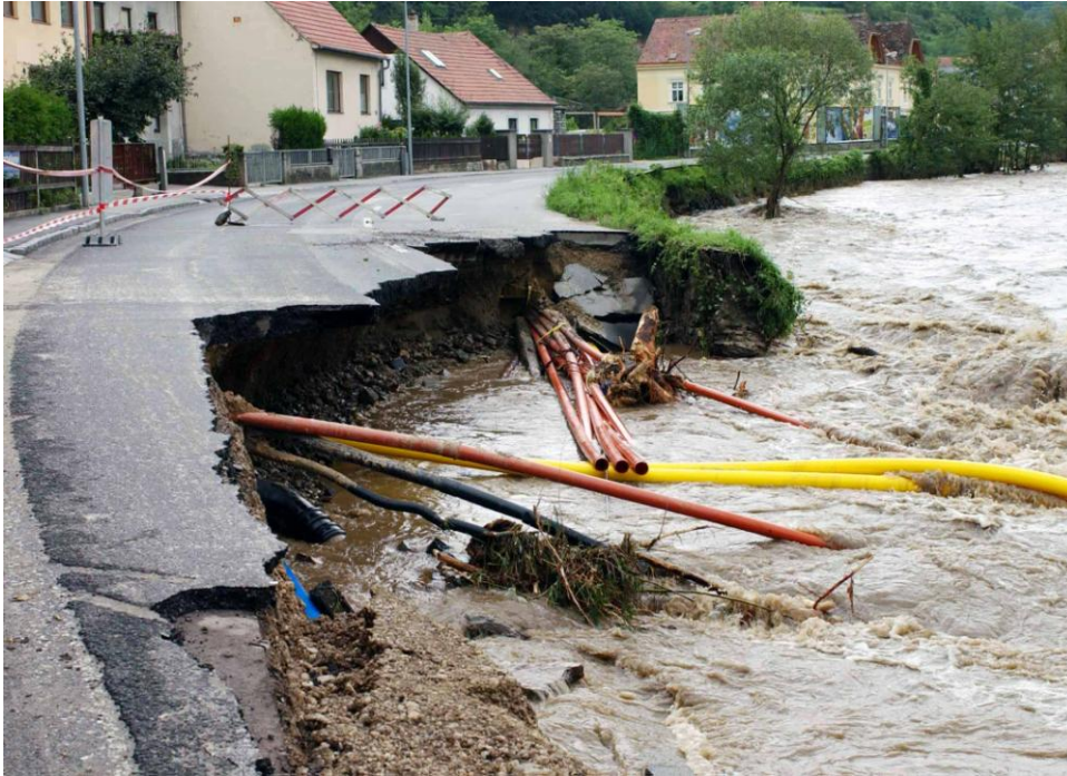
Abbildung 6: Ufererosion - Unterspülte Straße nahe einem Oberflächengewässer ( www.bundesheer.gv.at , Zugriff am 1.10.2012)
